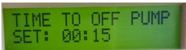
Rys. 7: Panel ustawienia czasu do wyłączenia pompy.
